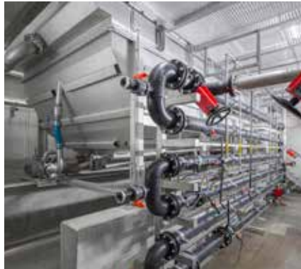
Postrojenje za rastvorenu vazдушnu flotaciju za pouzdanu obradu otpadnih voda.
