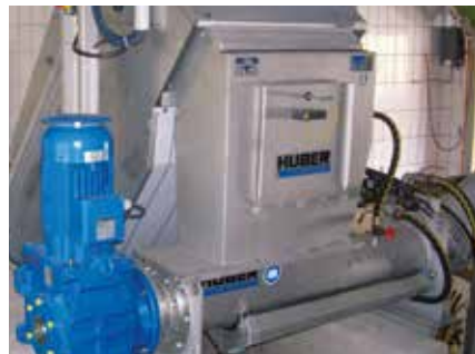
HUBER Presa za Pranje WAP® je instalirana iza HUBER Fine Rešetke STEP SCREEN®.
