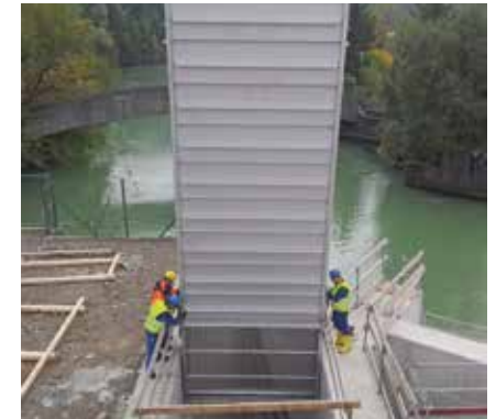
Proces filtriranja rečne vode pomoću HUBER Multi-Rake Bar Screen RakeMax® V, za velike količine otpadnih voda.
