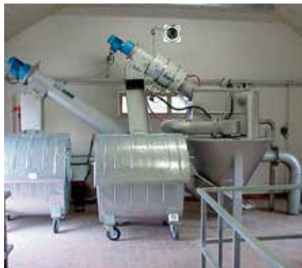
Potpuni sastav za prihvatanje otpadnih voda u jednoj zatvorenoj i kompaktnoj jedinici, idealan za mala postrojenja.
