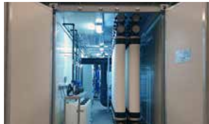
Faza prethodne obrade koristi ultrafiltraciju za uklanjanje suspenzija.
